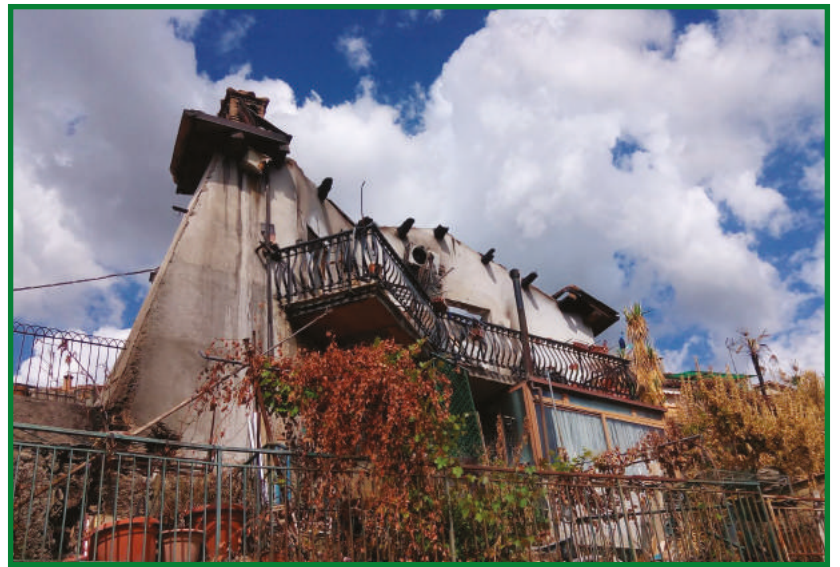
I danni dell'incendio
